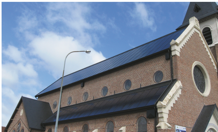
Panneaux photovoltaïques sur l'église de Loos-en-Gohelle
